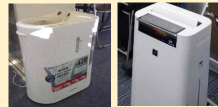
空気清浄機を設置
